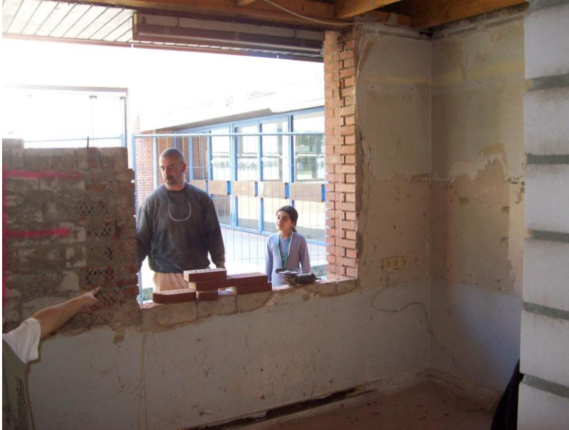
Die rausgebrochenen Fenster
